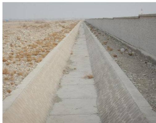
飞行区浆砌石截水沟
